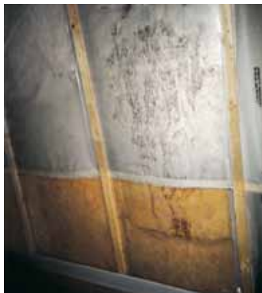
Aantastingen veroorzaakt door het plaatsen van vochtig hout in combinatie met een traditioneel dampscherm.
